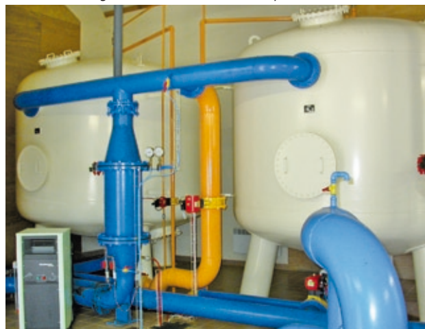
Filtres de déminéralisation (distribution d'eau potable, ville de La Flèche).
